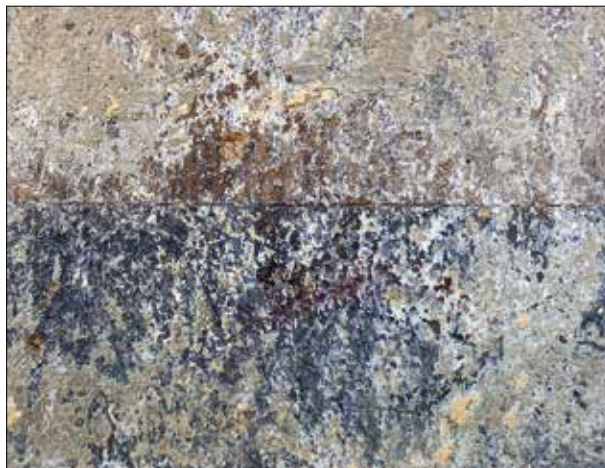
Obr. 21. Reálná nálezová situace s odhalenými, značně poškozenými původními úpravami fasády. Iluzivní kordonová římsa oddělená patrným rysem je provedena tmavě šedě, na tmavém pozadí jsou v ploše viditelné nepravidelné, jasně ohraničené červené skvrny, které byly in situ interpretovány jako mramorování. Stratigrafií úprav v místě červeného mramorování, která této hypotéze odpovídá, zachycuje obr. 20.
