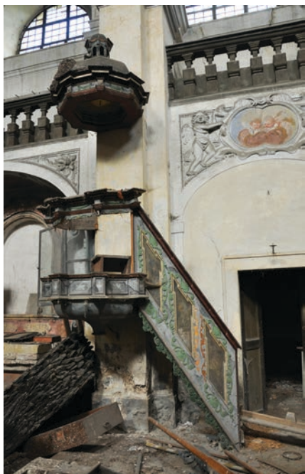
Obr. 24. Zahořany, kostel Nejsvětější Trojice, presbytář, silně poškozená malovaná kazatelna patří k souboru originálního vybavení kostela, které vzniklo pravděpodobně společně s výstavbou kostela mezi lety 1653–1657. Foto: Táňa Nejezchlebová, 2012.
