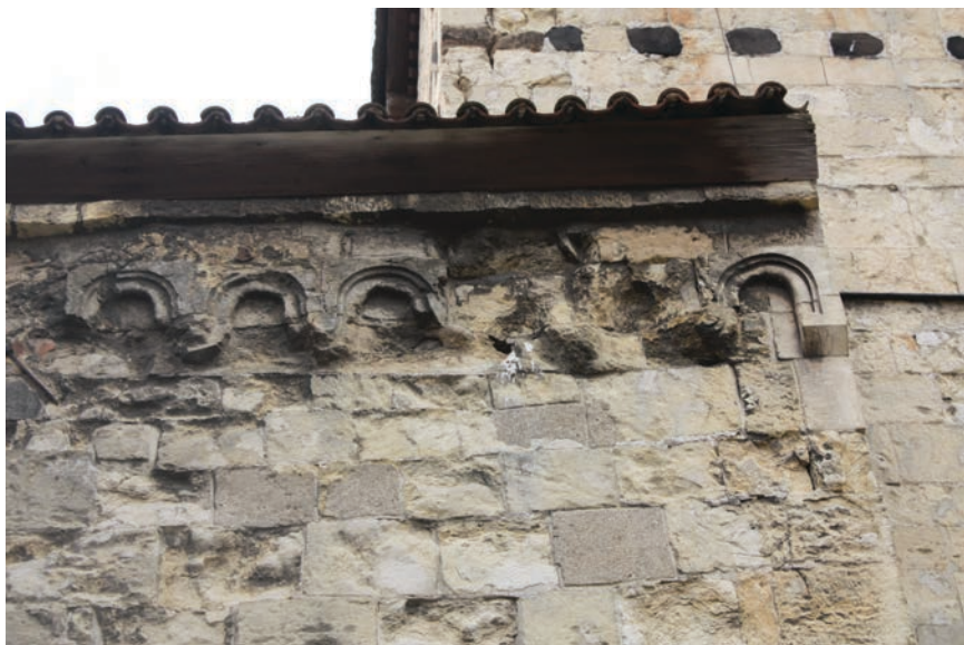
Obr. 11. Libčeves, kostel Stěti sv. Jana Křtitele – detail destrukce románského obloučkového vlysu pod hlavní římsou kostela. Stavba nemá okapy, voda ze střechy volně stéká právě na tyto partie stavby. Foto: Lucie Radová, 2009.
