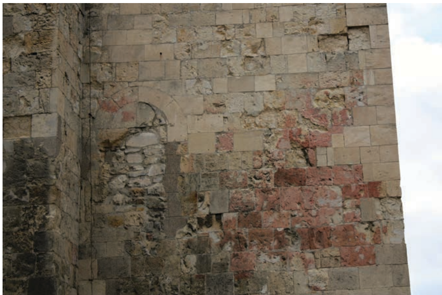
Obr. 10. Libčeves, kostel Stětí sv. Jana Křtitele – situace odhaleného zdiva na severním průčelí věže se starším zazděným otvorem a různými typy kamenů, které patří různým historickým etapám stavby – indikace pro provedení případné fotogrammetrie. Foto: Lucie Rádová, 2009.
