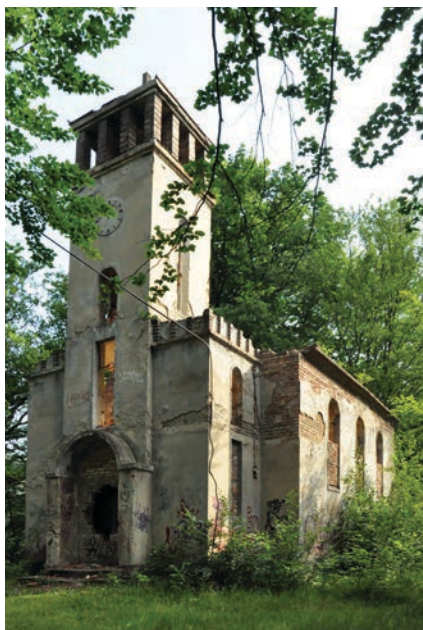
Obr. 7. Děčín – Nové Město, starokatolický kostel, nedostatečný odstup od objektu a pohled způsobuje zejména u věže sbíhání os a vytvoření dojmu tzv. padání. Foto: Táňa Nejezchlebová, 2012.
